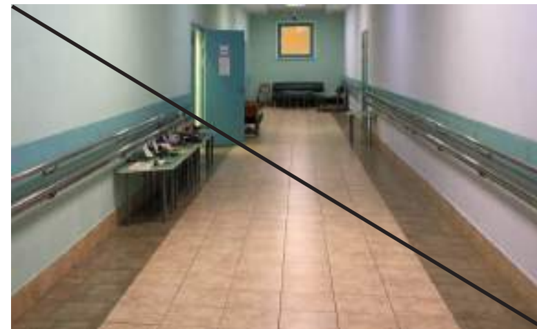
Плохо Керамогранитная плитка с крупными швами
